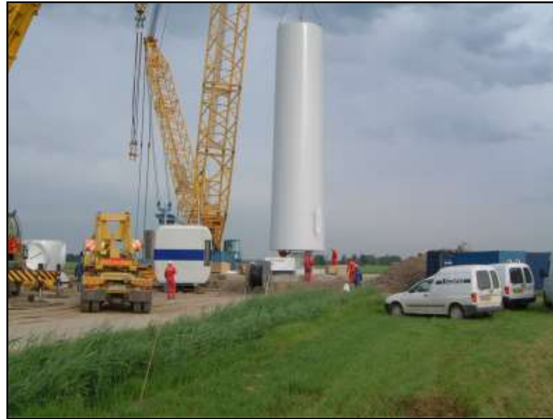
Figure 79 : Montage de la première section du mât
