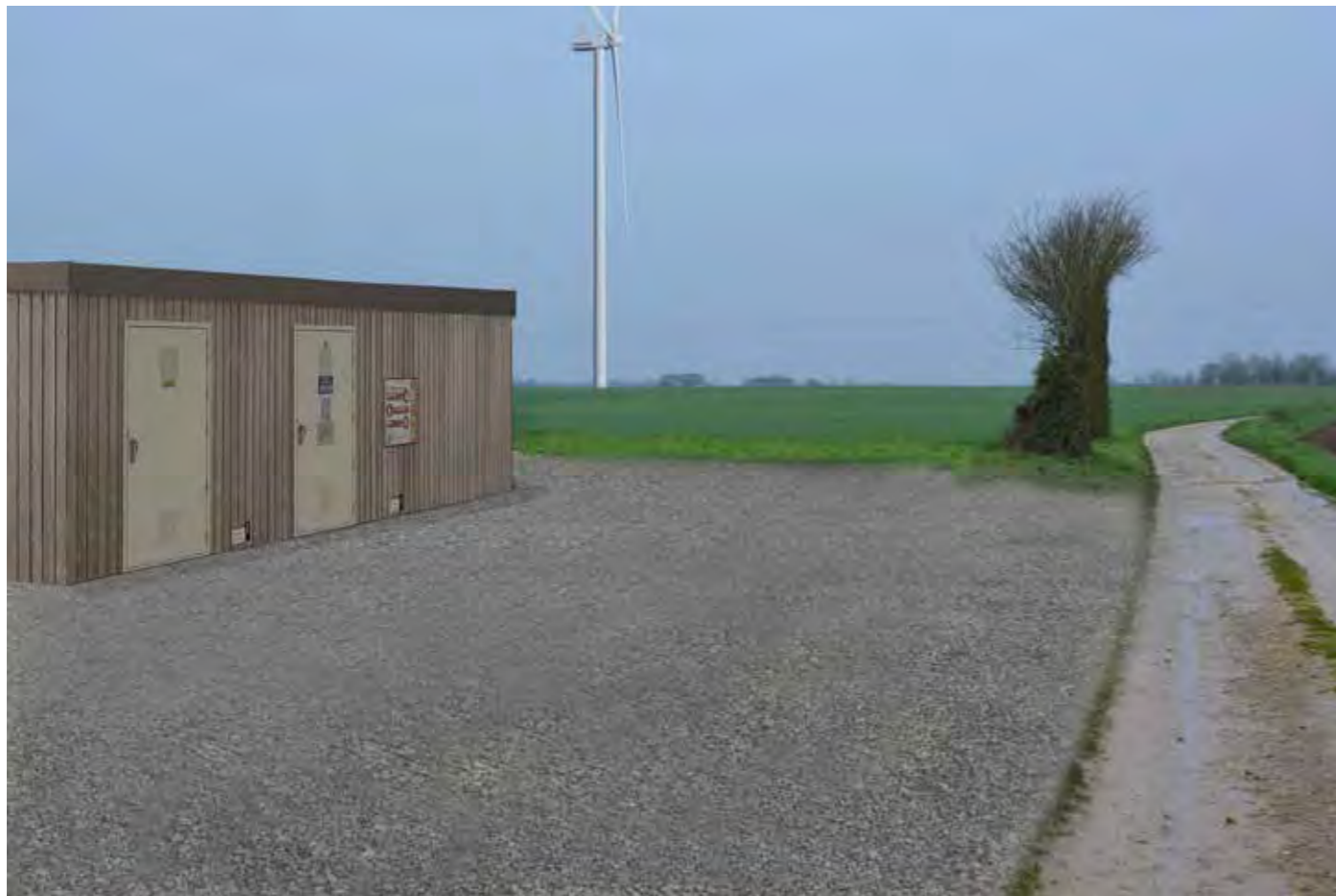
PHOTO 181 : VUE SUR UN POSTE DE LIVRAISON (PDL 1) LE LONG D'UNE ROUTE COMMUNALE SUR LA PARTIE NORD DU PROJET
