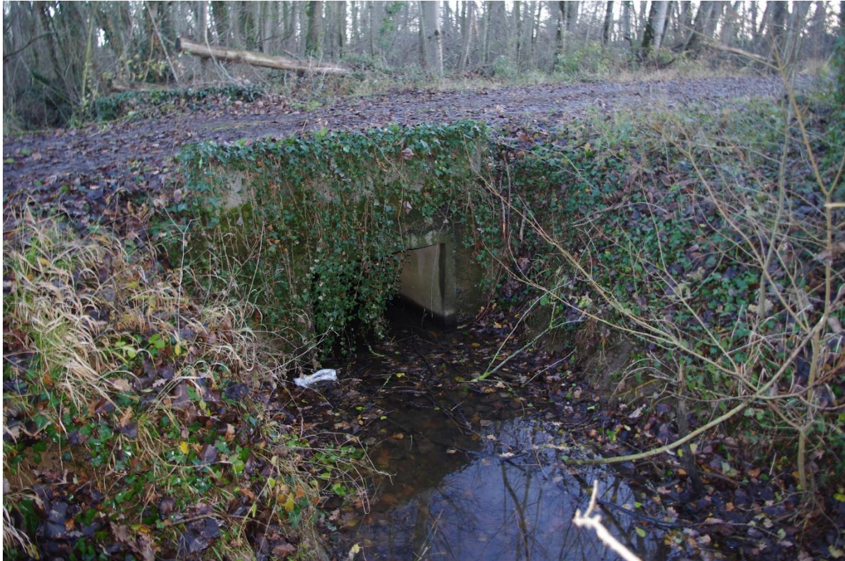
Pont sur lequel le câble traversera le ruisseau au fond de la vallée
