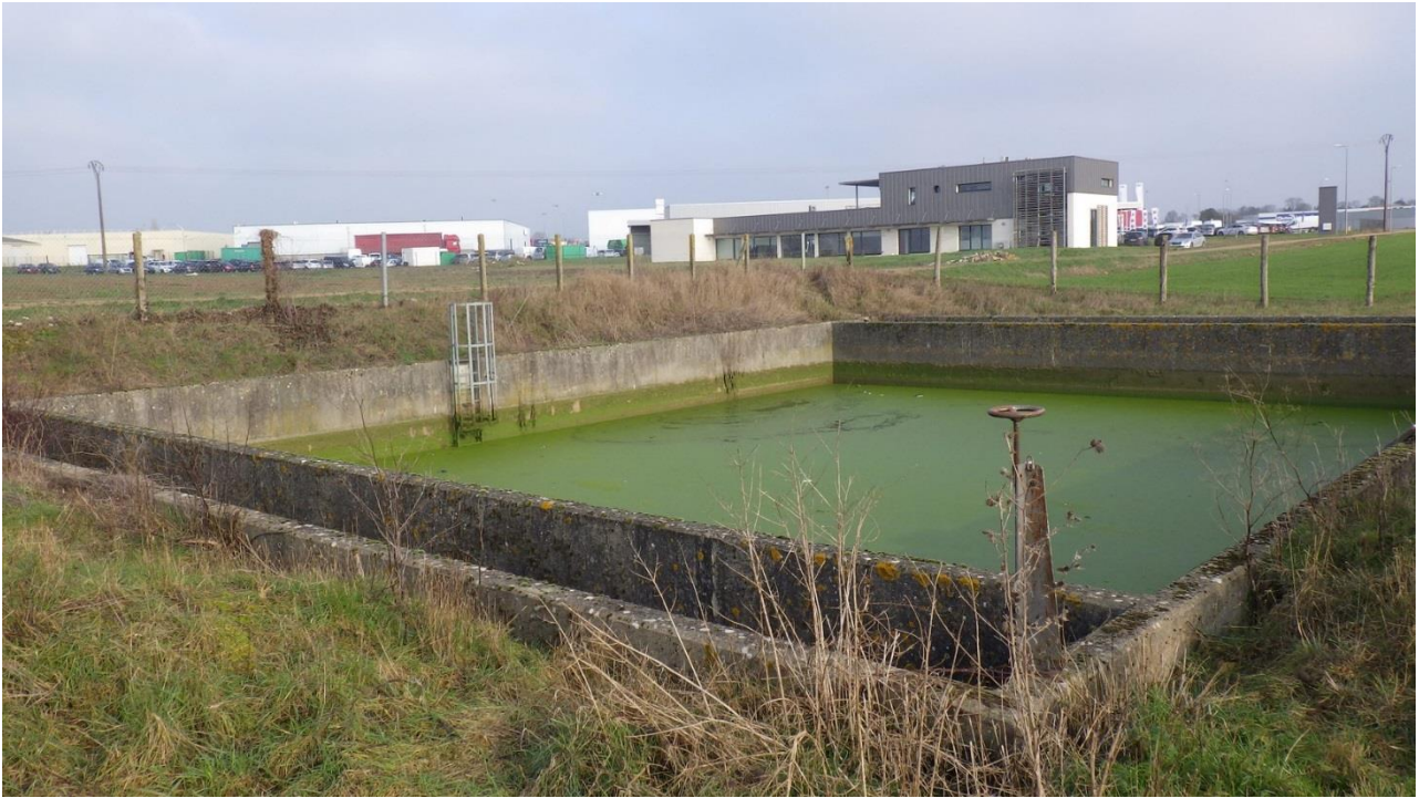
Photo 1 : ouvrage de décantation et de déshuilage en amont du bassin d'infiltration
