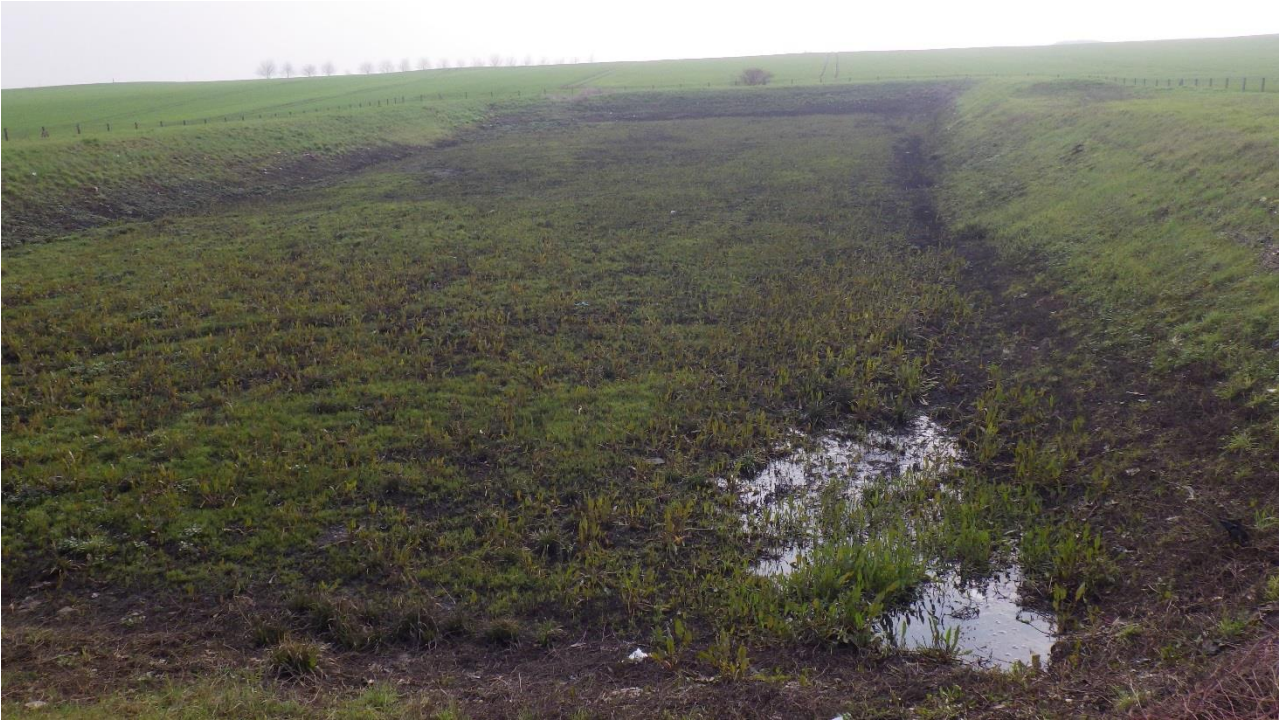
Photo 3 : bassin actuel d'infiltration
