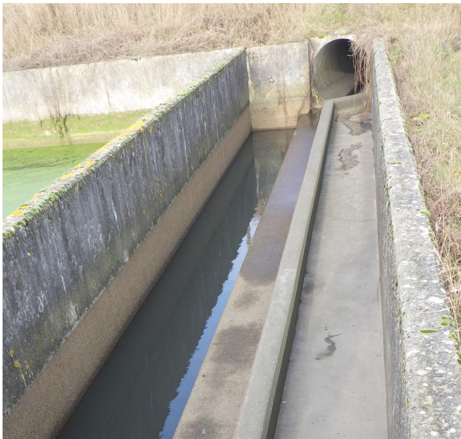
Photo 2 : arrivée des eaux pluviales
