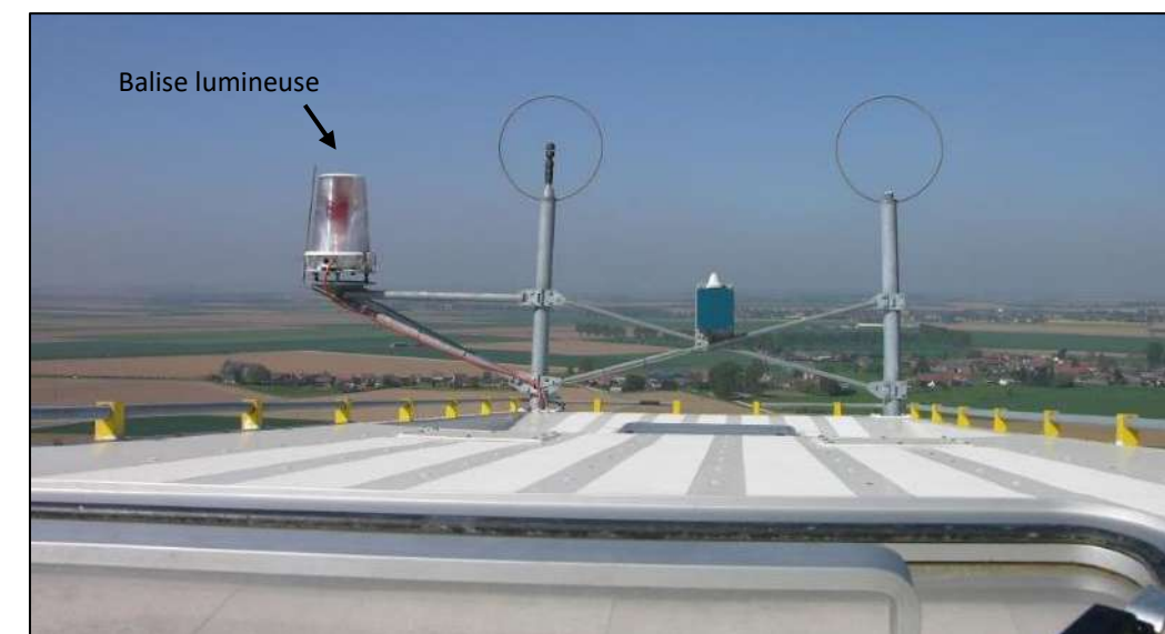
Figure 27 : Système de balisage lumineux (Source : EOLISE)
