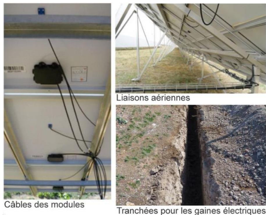
Photographie 9 : Liaisons électriques (Source : ENCIS Environnement)
