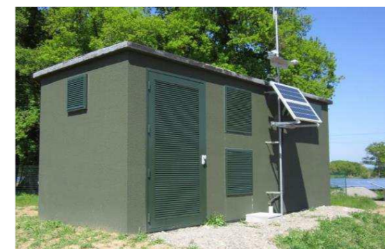
Photographie 8 : Exemple de poste de livraison (Source : ENCIS Environnement)
