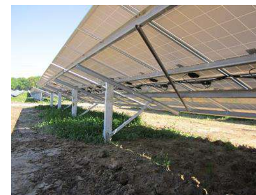
Photographie 57 : Structures porteuses des tables photovoltaïques (Source : ENCIS Environnement)
