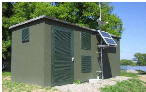
Photographie 59 : Exemple de poste de livraison (Source : ENCIS Environnement)
