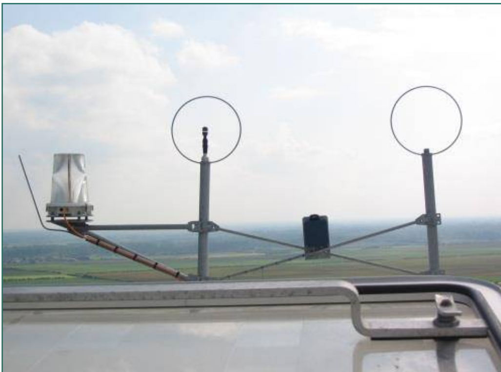
Figure 11 : Photographie d'un exemple de balisage aéronautique
