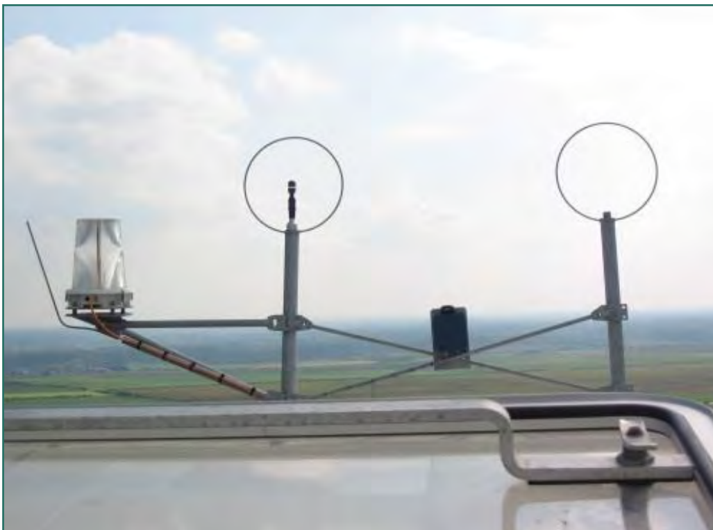
Figure 10 : Photographie d'un exemple de balisage aéronautique
