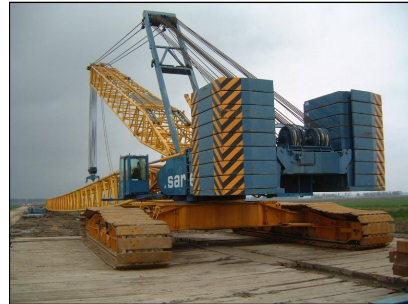
Photographie 5: Photo de la grue permettant l'assemblage des différents éléments d'une éolienne
